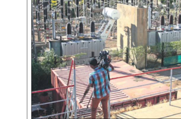
محطة كهرياء سنار على بعد 300 كيلومتر جنوب الخرطوم (الراهمي خاصه/ترانس برس)
