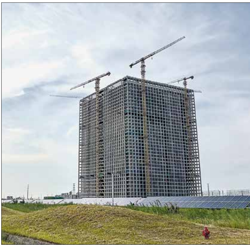
الصين تقود ثورة في تخزين الطاقة الكهربائية ببناء بطارية بحجم عمارة
