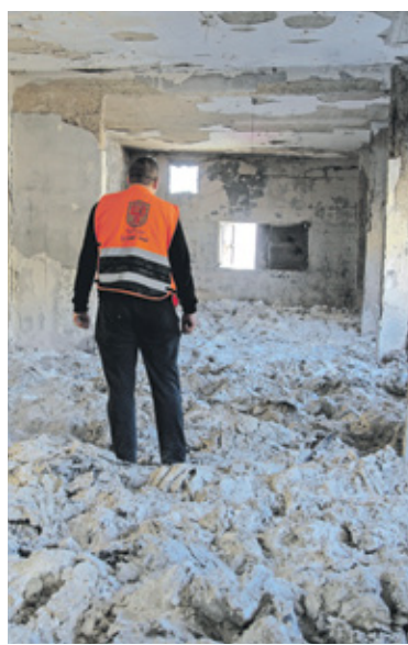
تحول مبنى الراشيف المركزي إلى ركام (فرانس برس)
